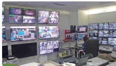
設備管理システム
