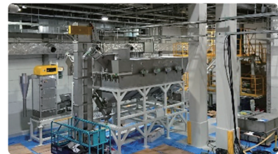
導入中の浮沈選別装置
