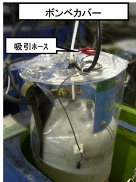
ポンベ上部に透明のカバーを取り付けることで微妙な漏洩も検知する
