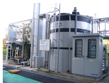
屋外の廃水処理設備
