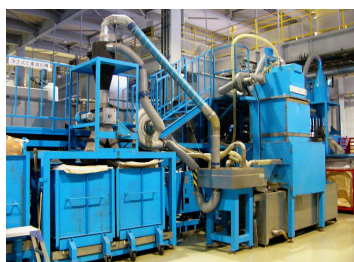
プラント内の廃水処理設備
