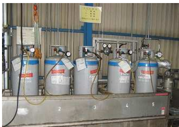
ボンベに回収されたフロン
