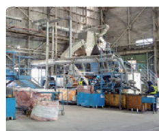
プリント基板破碎設備
