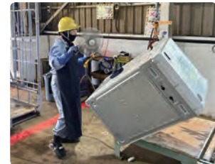
エアコン室外機と同じ1点吊り
