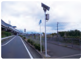
ソーラー式監視カメラの設置
