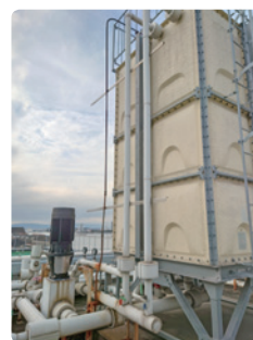
＜散水タンクを屋上に設置＞
